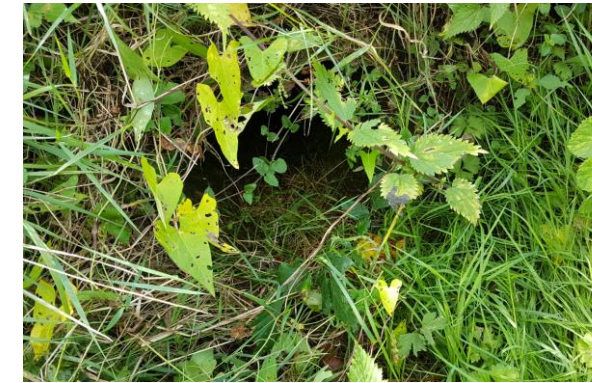
Photo 18 : Buse de diamètre 400 passant sous la RN147 au droit du point bas
